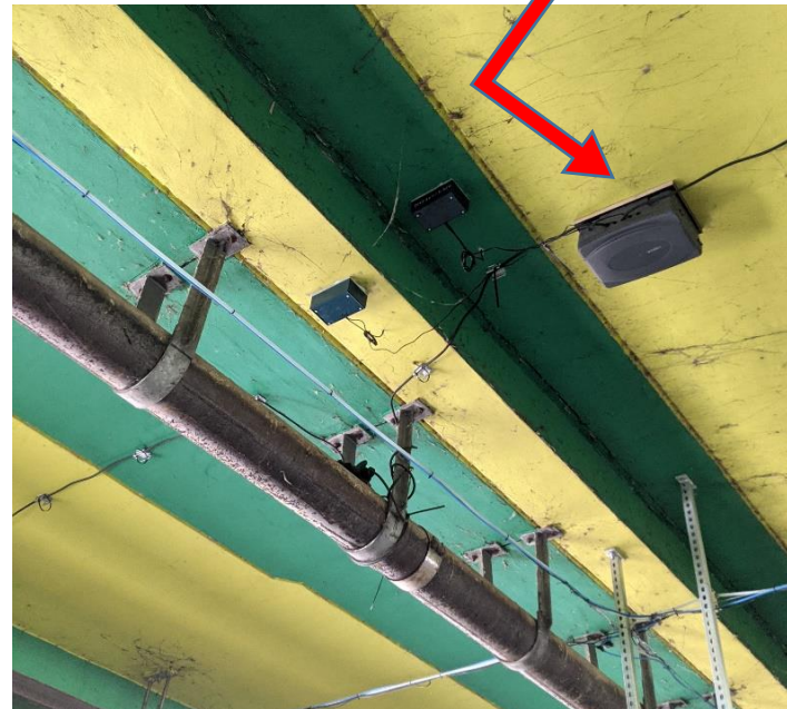
Stromversorgung und Sensoren Kragarmenden Innen
